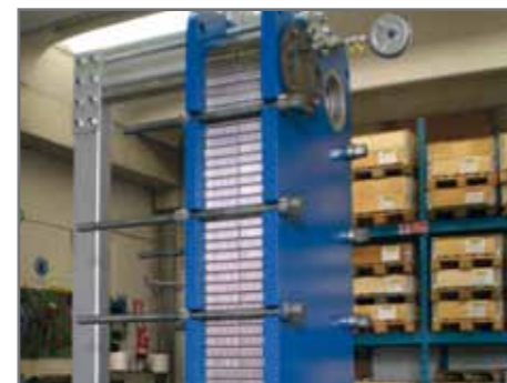
Prova di tenuta su scambiatore rigenerato
