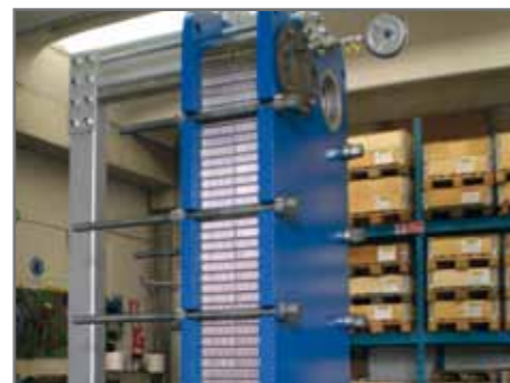
Prova di tenuta su scambiatore rigenerato
